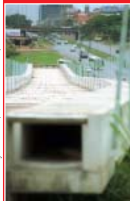
Taguatinga: obra do metrô está abandonada
